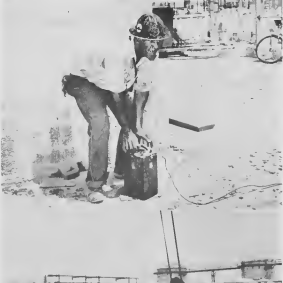
NA E sitio di e Still No. 12 cu a wordo kibra, empadonnan di Mechanical-Yard recientemente tabatin e trabao di hula e fundeshi di concreto cu dinamiet. Un mat doblo di cabayo, portret arriba, a wordo usá pa proteccion den e trabao aki. Trahadornan ta yena un buraco cu pida dinamiet.
